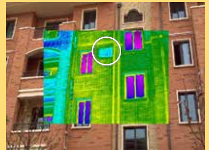
外墙维修后未填实，该处容易渗水
